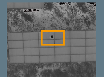
モジュール割れ
