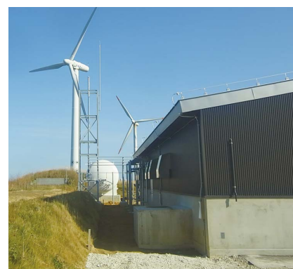
苫前水電解実証設備(北海道)
